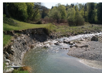
Exemple d'affaissement de berge sur la Menoge source : Fillinges
